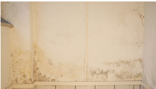
Schimmel an den Innenwänden einer Wohnung
